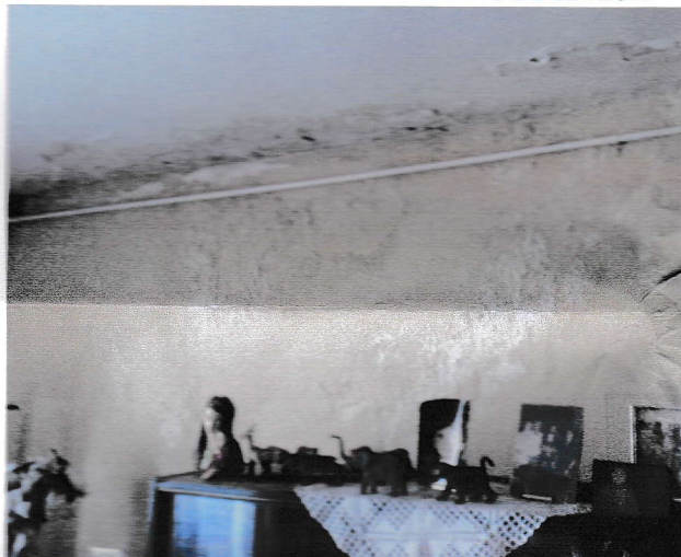
9 STANJE OŠTEĆENJA ZIDA I PLAFONA – STAN BR. 17
