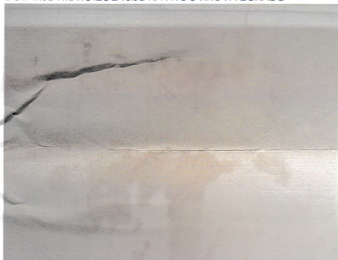
10 STANJE OŠTEĆENJA ZIDA – STAN BR. 14
