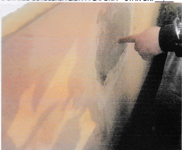
11 STANJE OŠTEĆENJA NA JUŽNOM DELU - ZIDA TERASE STANA BR. 15
