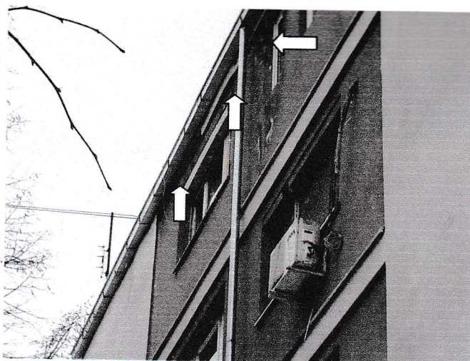
18 MESTO GDE JE OTPALA FASADA NA DELU PREMA ULICI DANA 23.01.2016 GOD I DEO OŠTEĆENE FASADE
